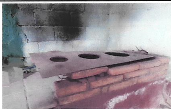
Foto 6: Cocina en mal estado
