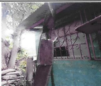
Foto 5: Canales y caídas de agua en mal estado
