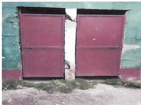
Foto 2: Puertas de baños en mal estado
