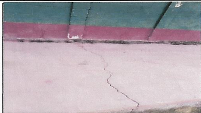
Foto1: Piso de corredor y aulas en mal estado
