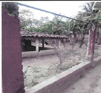
Foto 4: cerco perimetral en mal estado
