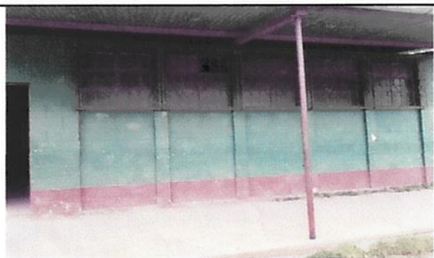
Foto 3: Pintura de la escuela deteriorada
